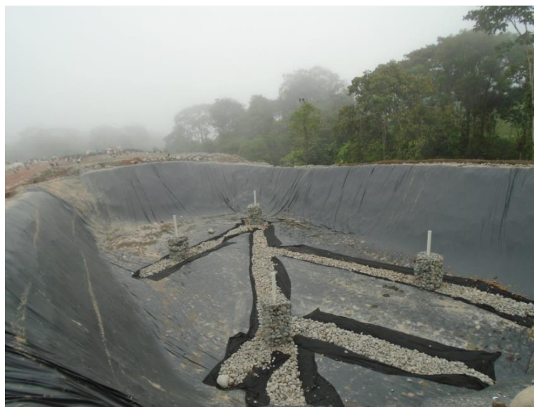
Fotografía 11. Geomembrana ubicada como parte de la ejecución del proyecto cierre técnico del Botadero, 2014.
