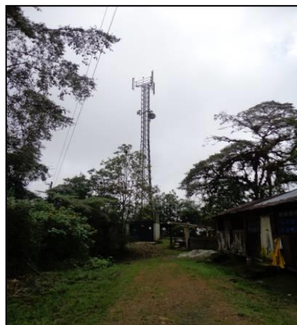
Fotografía No. 12. Antena Claro Fuente: IEE, 2014
