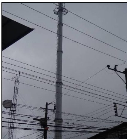
Fotografía No. 11. Antena CNT Fuente: IEE, 2014
